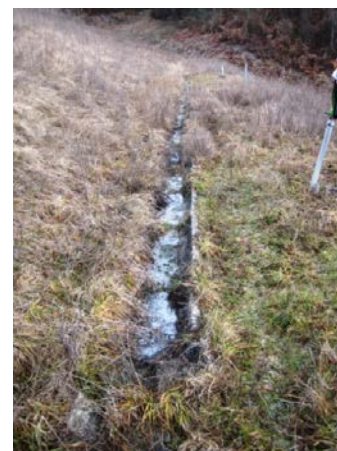
c) zastajanje vode v zbirnem kanalu na bermi
