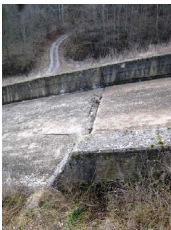
a) Slabo stanje betona na drči pri prehodu čez teme pregrade
