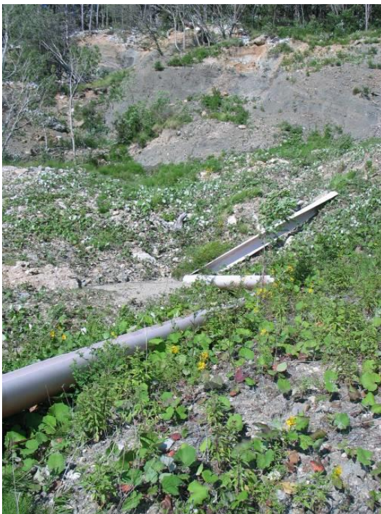
Slika 62 (levo): Prestavljene in poškodovane cevi pod zahodno brežino (Vir: Mikec, 2012)
