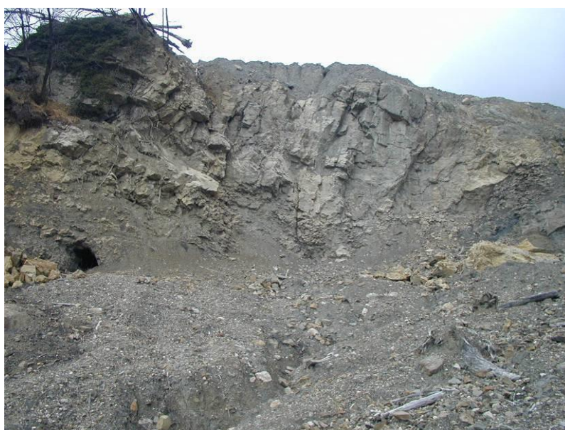
Slika 54: Pogled na čelo strme razpokane kamnite brežine – slap Grajšček pred sanacijo (Vir: Majes, 2005c: str. 4)
