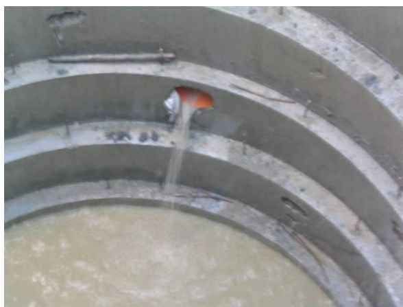
Slika 42: Močan dotok podzemne vode v AB vodnjak
