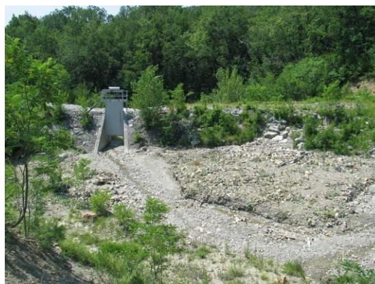
Slika 35: Kamnita pregrada za ustavitev drobirskih tokov nad vasjo Lokavec z zapornico (Vir: Mikec, 2012)
