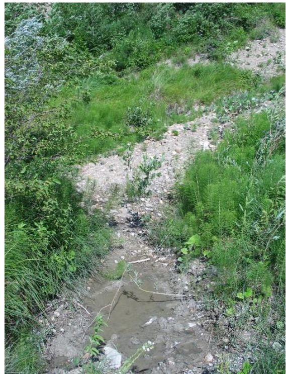
Slika 63 (desno): Izvir vode, ki zamaka zemljino pod zahodno brežino (Vir: Mikec, 2012)
