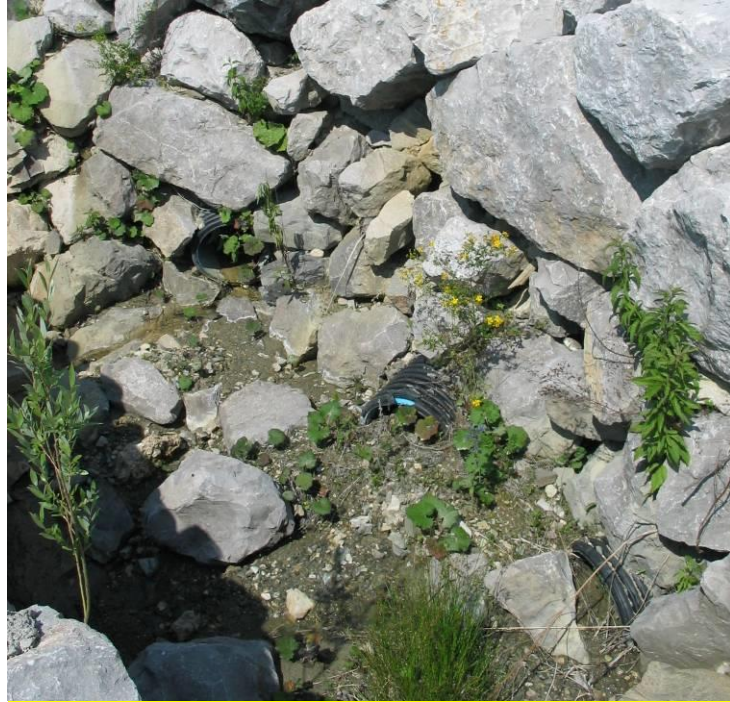
Slika 66: Zamašena izpusta drenaž J2 in J3 (Vir: Mikec, 2012)
