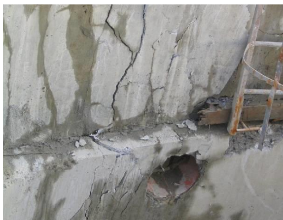
Slika 41: Poškodbe primarne obloge vodnjaka M2
