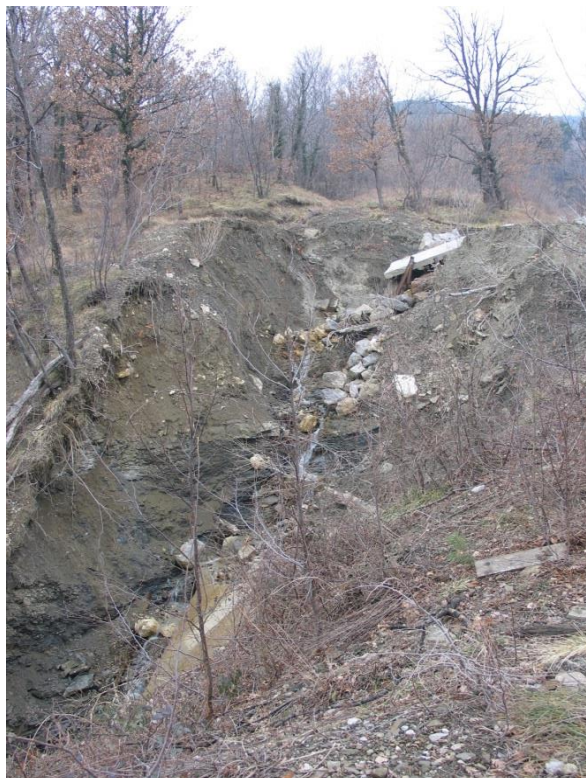
Slika 68 (desno): Zaradi regresivne erozije porušena betonska brv in del ureditve Grajščka nad slapom (Vir: Mikec, 2013)
