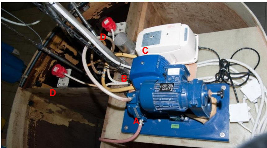
Slika 12: Strojn tehnološka oprema na pilotni čistilni napravi Picture 12: Equipment on pilot plant
