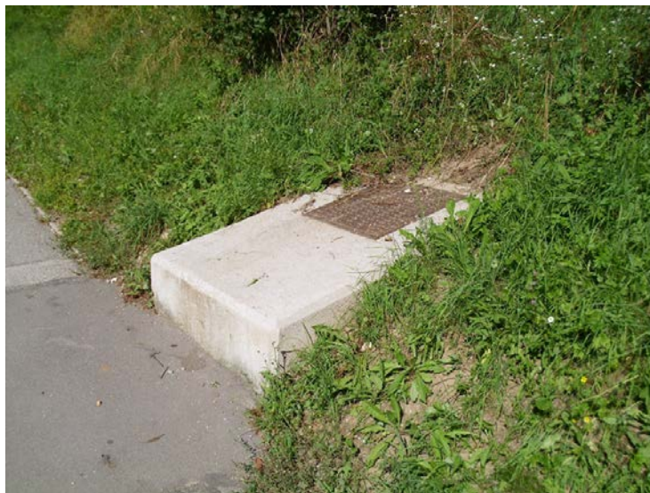
Slika 13: Pravokoten jašek komunalnih vodov na betonskem temelju
