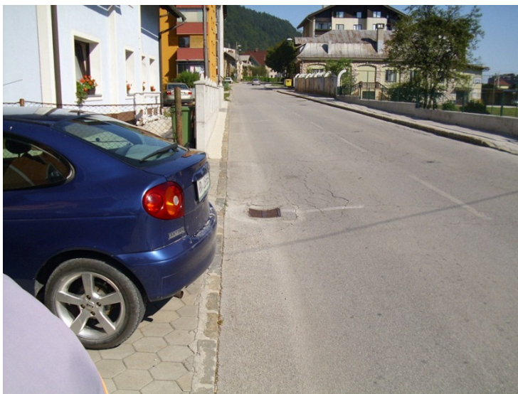
Slika 9: Ena od pravokotnih rešetak ob severnem robu cestišča
