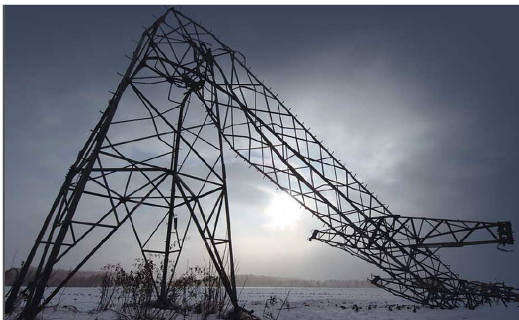
Slika 7: Upogib daljnovodnega stebra vzdolž daljnovoda (vir: Siemens, 2006)
