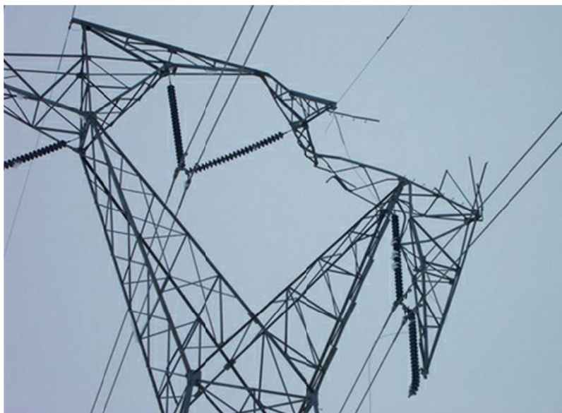
Slika 6: Porušitev glave daljnovodnega stebra oblike "Y" (vir: Basin Electric, 2010)
