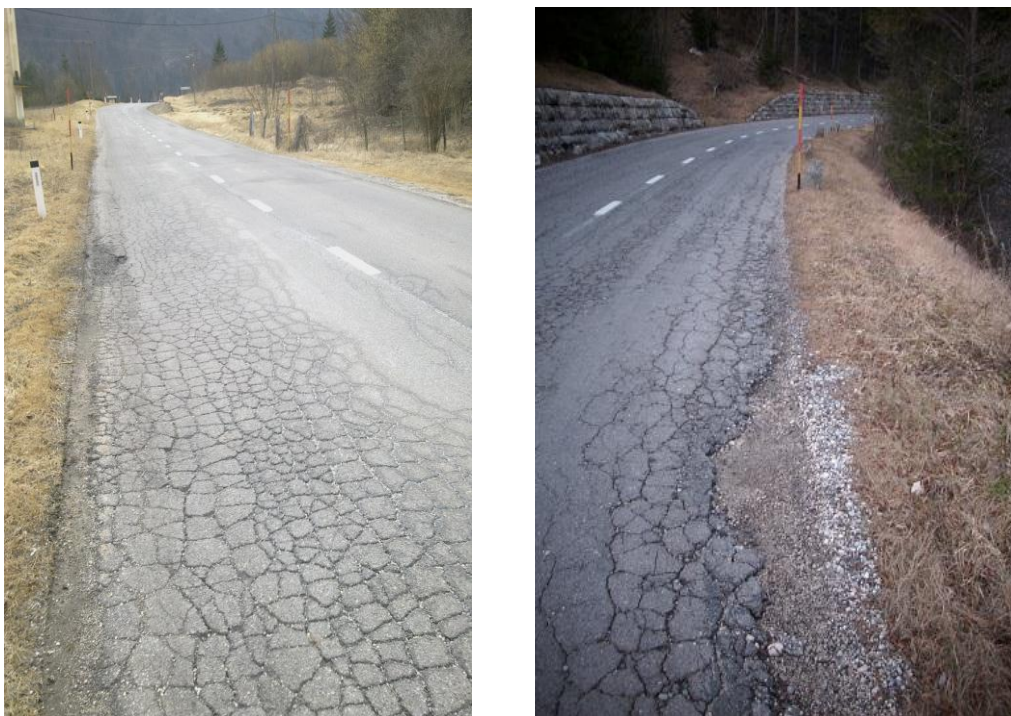
Slika 5: Dodatnemu vlaženju zaradi slabega odvodnjavanja sledi porušitev vozišča
