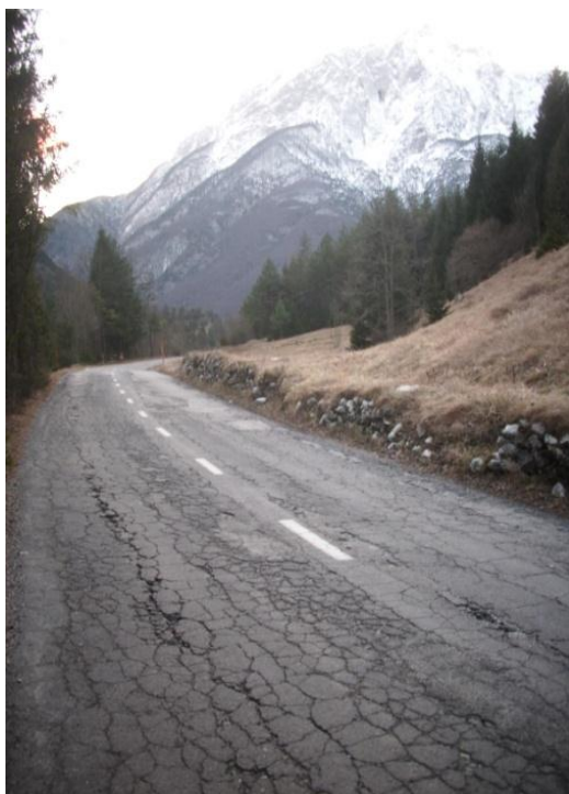
Slika 2: Globoke in široke mrežaste razpoke po celotnem asfaltnem vozišču
