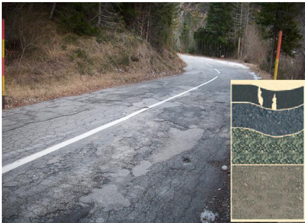
Slika 1: Dotrajana cesta potrebna globinske sanacije
