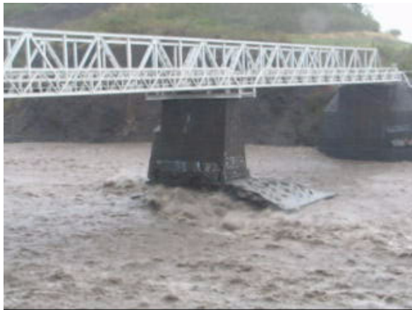
Fig. 15 Pont métallique, embase partiellement détruite
