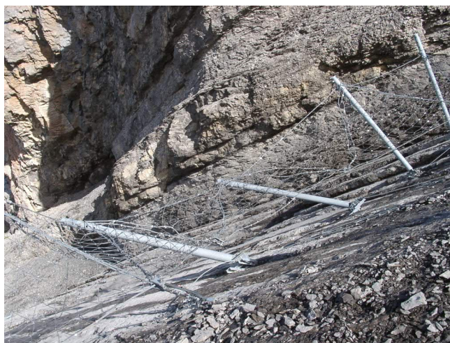
Fig. 5 Rupture de la ligne amont du dispositif
