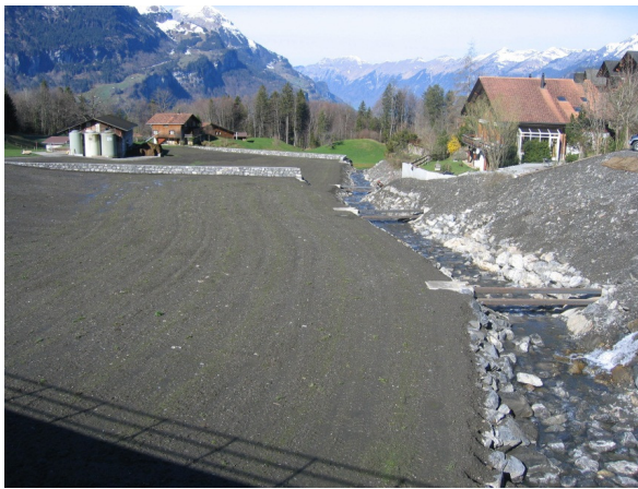
Fig. 15 Terrasses 2 et 3 en rive gauche du cours d'eau à la fin des travaux. Les épis de fermeture des terrasses et les grilles-seuils dans le lit sont visibles
