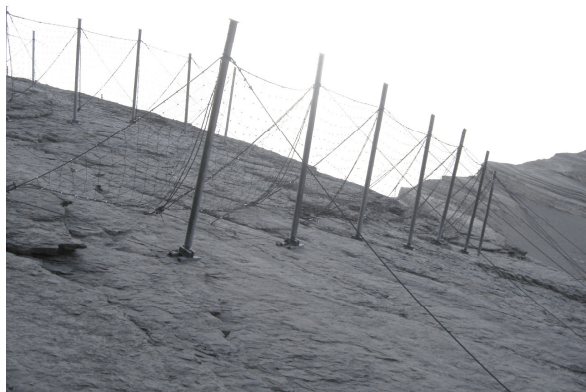
Fig. 4 Filets paravalanches sur dalles inclinées
