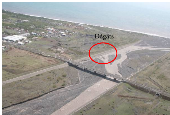
Fig. 9 Partie endiguée (Cyclone Gamède 2007)
