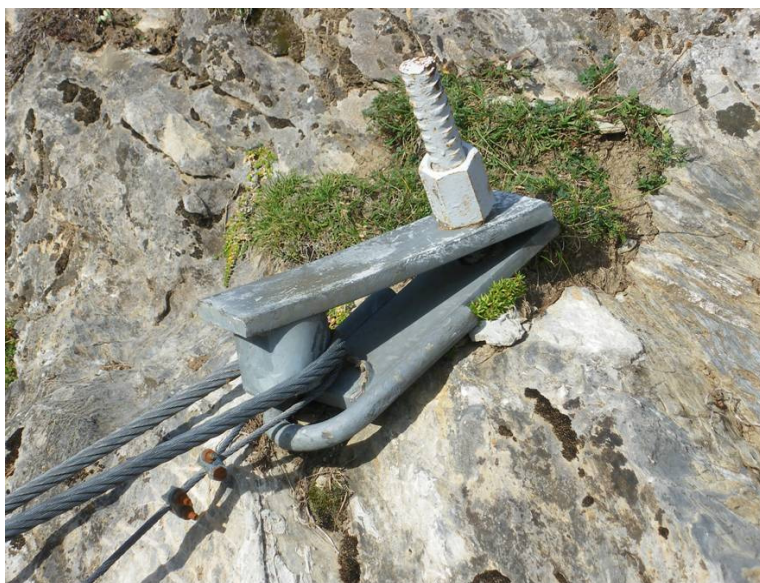
Fig. 3 Pièce d'ancrage défectueuse Fig. 3 Faulty piece of an anchoring
