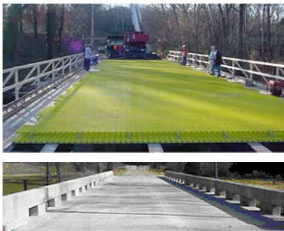
Slika 26: Stanje med in po sanaciji
