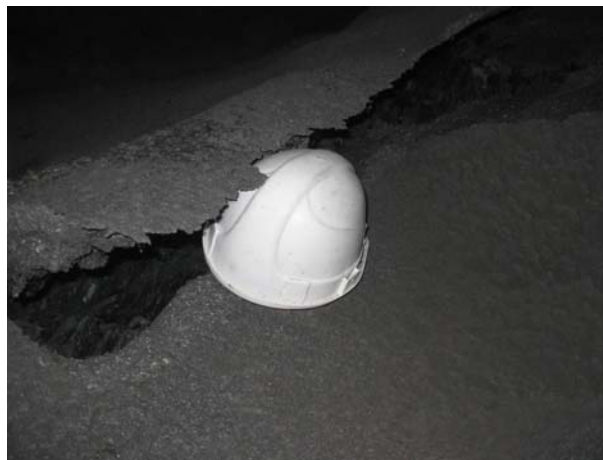
Slika 6.2.10: Vzdožna razpoka v raziskovalnem rovu na višini 1 m nad niveleto.
