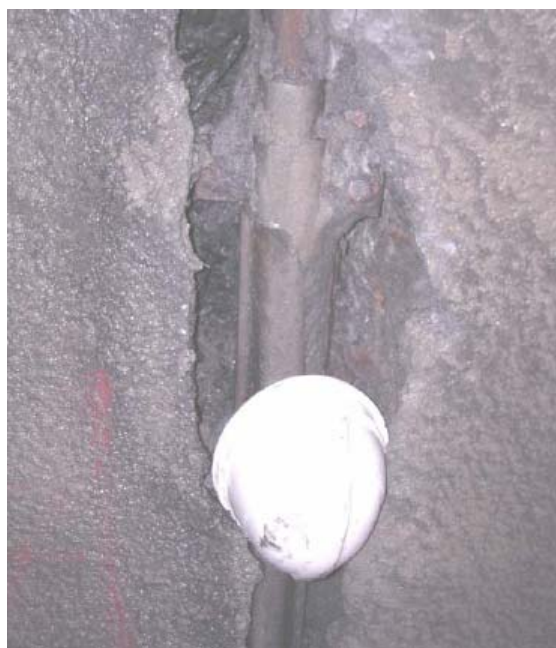
Slika 6.3.11: Prečne razpoke na mestu lokov v oblogi raziskovalnega rova.
