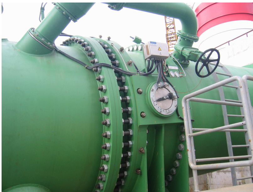
Lokacija meritve tlaka na vodostanski loputi (Arhiv Litostroj Power d.o.o.)
