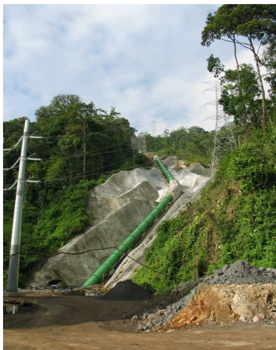
Tlačni cevovod (Arhiv Litostroj Power d.o.o.)
