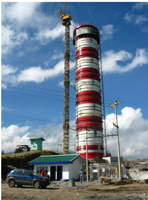
Vodostan (Arhiv Litostroj Power d.o.o.)
