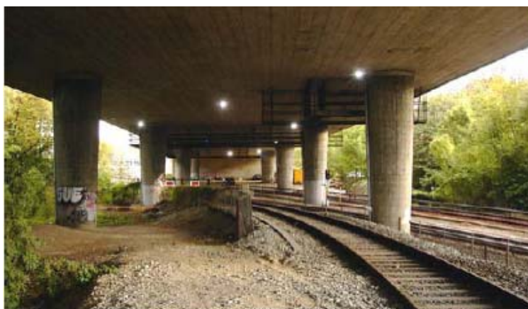
Slika 9: Prizme nameščene pod stropom mostu (Schäfer et al., 2006)
