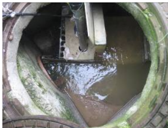
Slika 13: Rešetka v dotočnem kanalu (9.10.2007)
