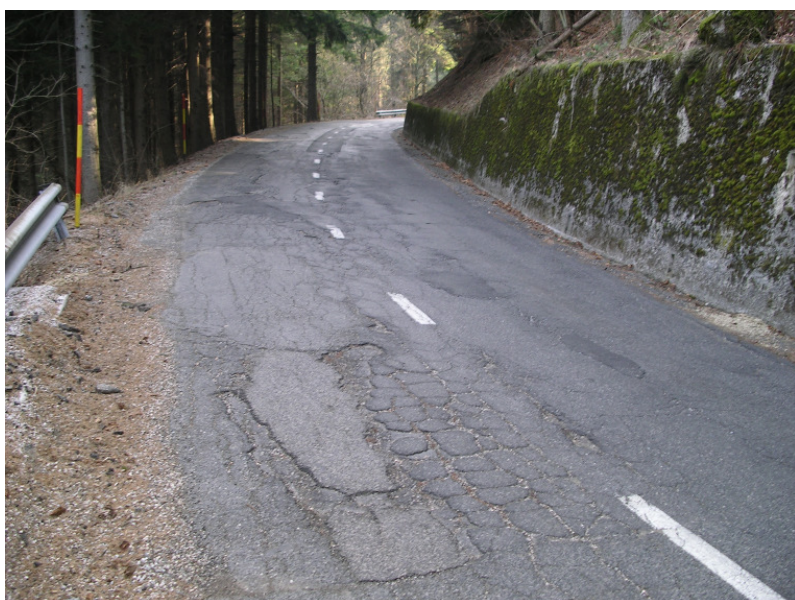
Slika 21: Strma brežina, poškodovano vozišče
