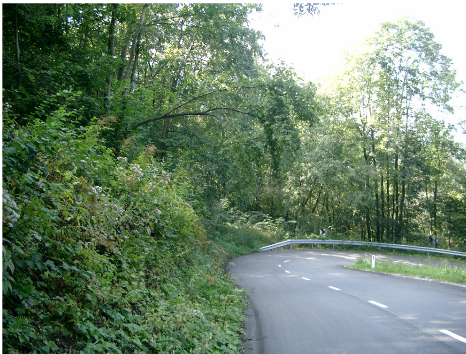
Slika 15: Skoraj podrto drevo visi nad cesto
