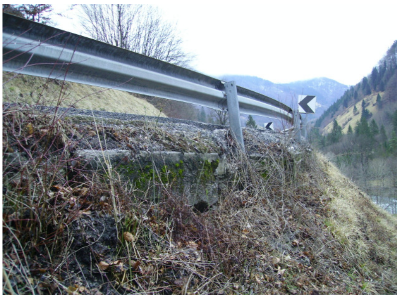
Slika 16: Močno poškodovan podporni zid na cesti 102, odsek 1036 Želin-Sp. Idrija
