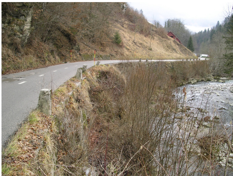
Slika 17: Močno dotrajan podporni zid brez betonske krone in varnostne ograje, strma brežina
