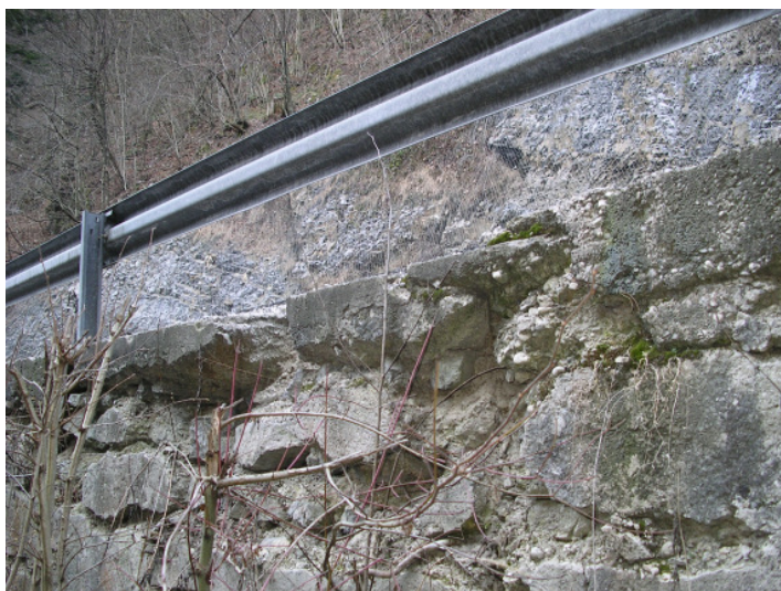
Slika 12: Razpadajoč zid narejen iz nekvalitetnega pustega nearmiranega betona
