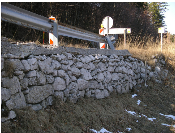
Slika 11: Zaradi preobremenitve napihnjjen suho zložen zid
