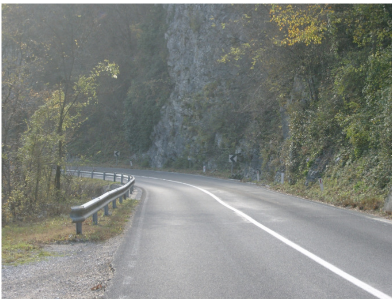
Slika 18: Strma brežina s katere je nevarnost padanja kamenja
