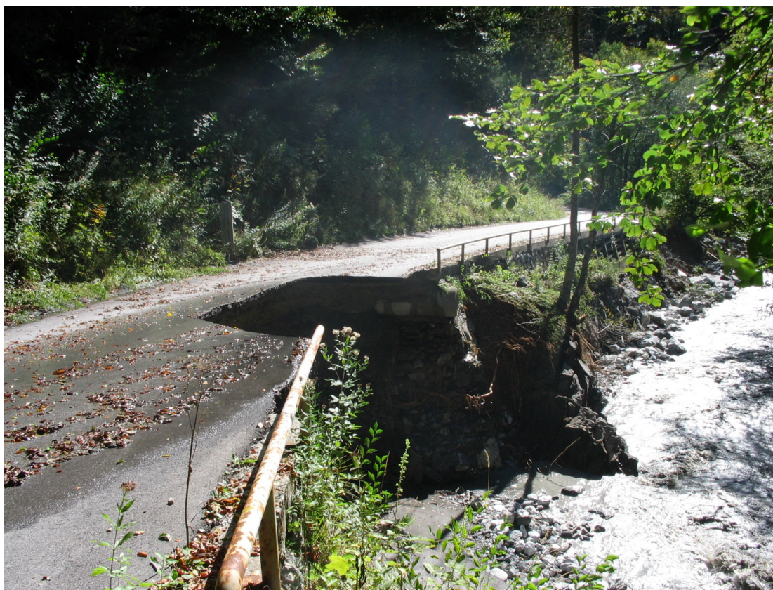
Slika 6: Primer elementarnega dogodka (vdor cestišča zaradi povodnji, Železniki, 18.9.2007)
