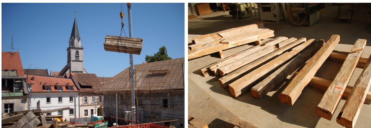
Slika 8.5 in 8.6: Prenos nosilcev s strehe lovskega dvorca (levo), pregled in označevanje nosilcev pred mehansko obdelavo (desno)
