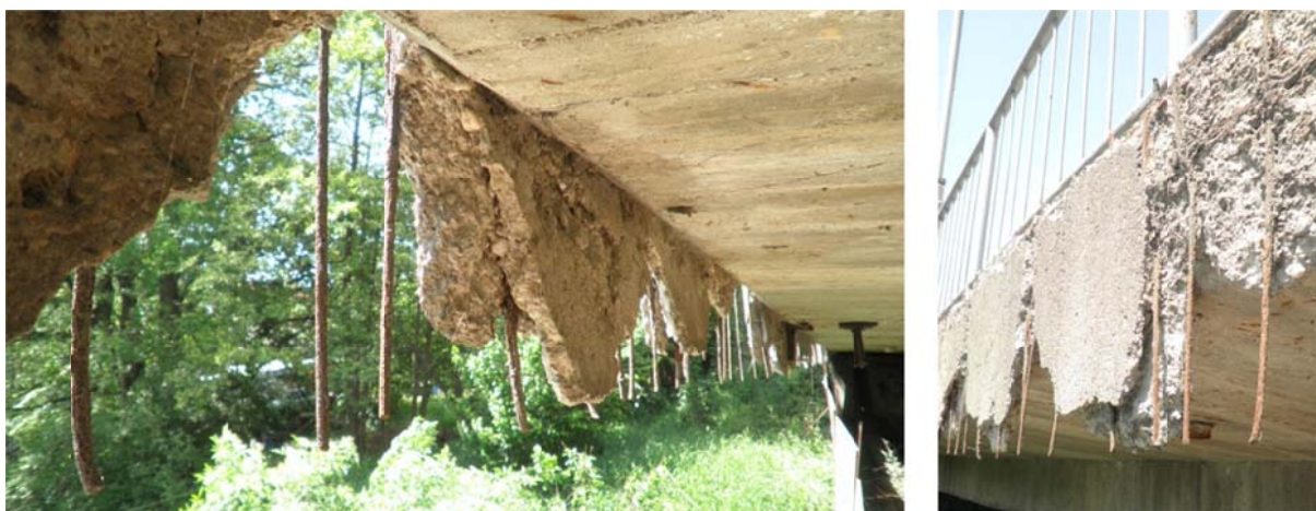
Slika 3: Poškodovani most čez Ljubljanico na priključku Vrhnika
