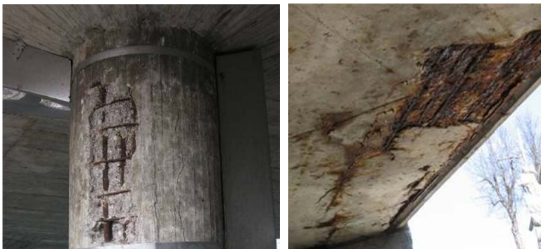
Slika 6: Levo: Primera močne korozije armature
