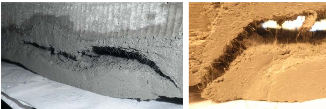
Slika 38: Sanacijska malta odpade z vzorca zaradi prevelikih pomikov in vibracij, ki so posledica togosti betonskega vzorca
