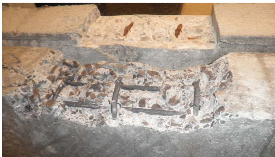
Slika 22: Betonski površini pripravljene z različnimi postopki, zgoraj površina pripravljena z ročnim odstranjevanjem betona in spodaj, kjer je bil beton odstranjen z vodnim curkom
