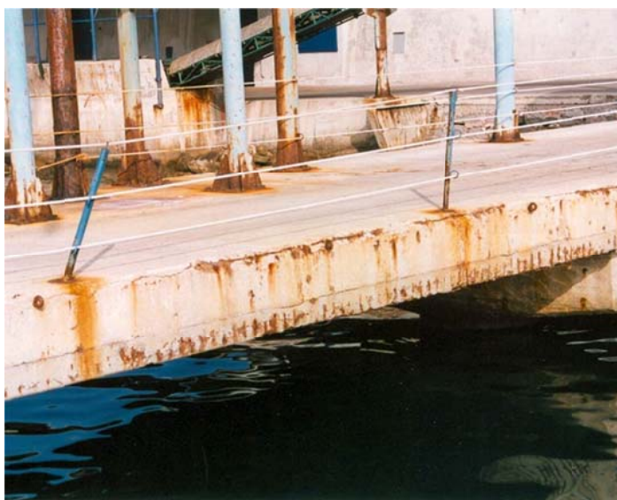
Slika 5: Močna korozija na betonskem objektu v morskem okolju
