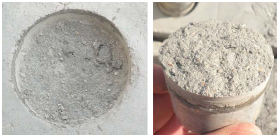
Slika 49: Prikaz porušениh površin Pull-off testa pri vzorcu 1 (malta Emaco S80 in ročno obdelana betonska površina). Vidne so praznine, ki so posledice slabše vgrajenosti malte
