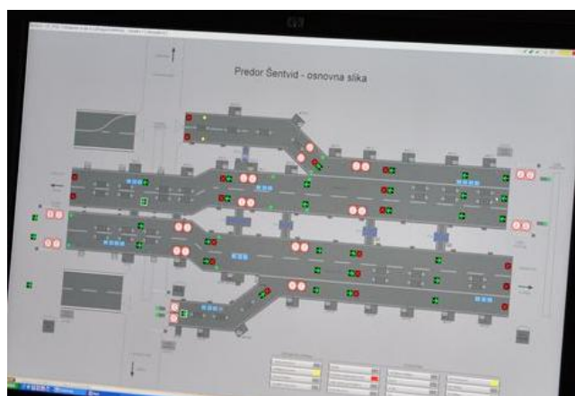
Slika 30: Osnovna slika predora Šentvid iz Prometno – informacijskega centra za nadzor in vodenje prometa v Dragomelju (PIC Dragomelj)
