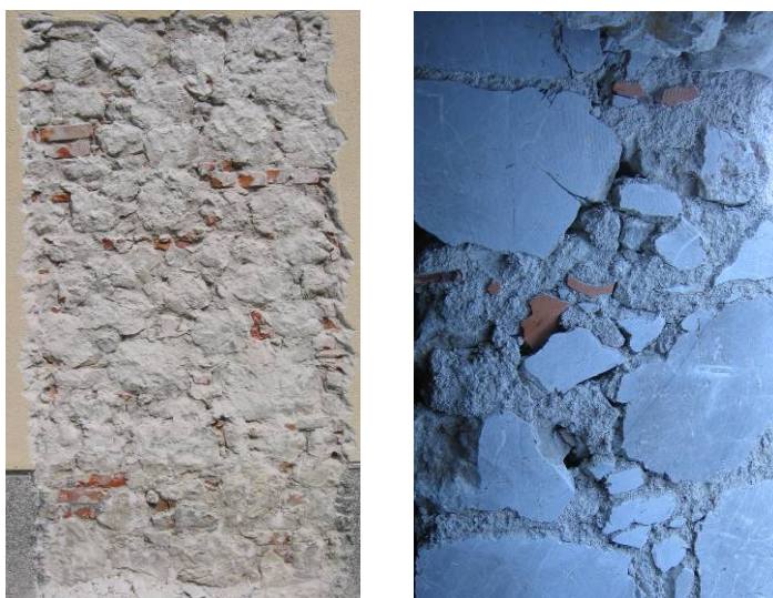
Slika 2.19: Tekstura in morfologija preskušenega kamnitega zidu podeželske stavbe v Čezsoči iz leta 1948
