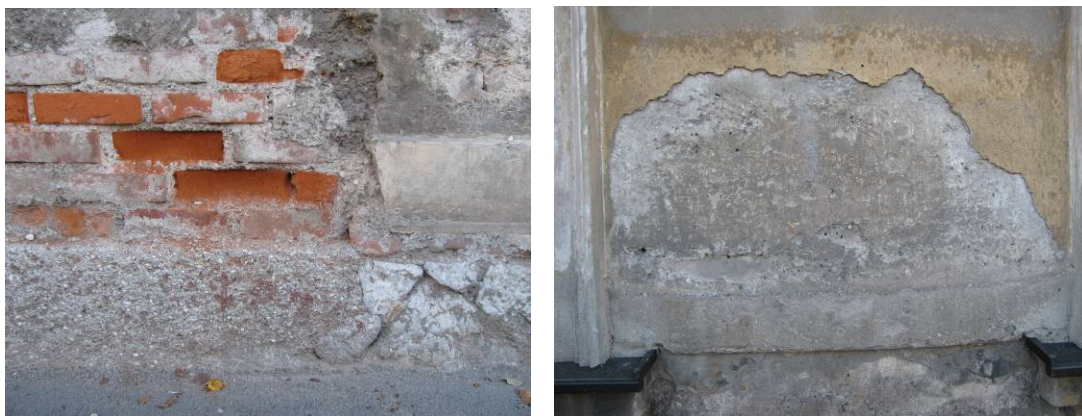
Slika 2.20: Zmrzlinke poškodbe opeke in ometa v območju podzidka (levo) in zaključnega sloja ometa (desno)
