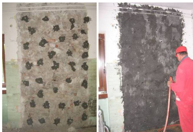
Slika 5.11: Priprava zidu 1-C1 in izvedba sistematičnega injektiranja Fig. 5.11: Preparation of the wall 1-C1 and execution of grout injection
