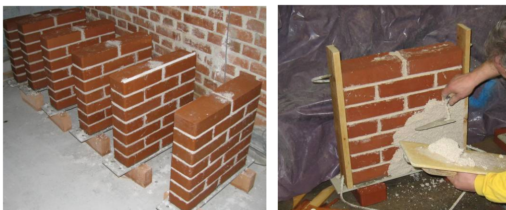
Slika 4.3: Rezultat zidarskega delovnega dne (levo) in ometavanje zidu po 4 mesecih staranja (desno)
