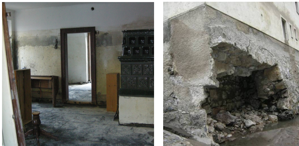
Slika 2.21: Nivo poplavne vode v notranjosti stavbe (levo) in poškodbe temeljne konstrukcije neposredno ob strugi (desno) med poplavami v Železnikih
