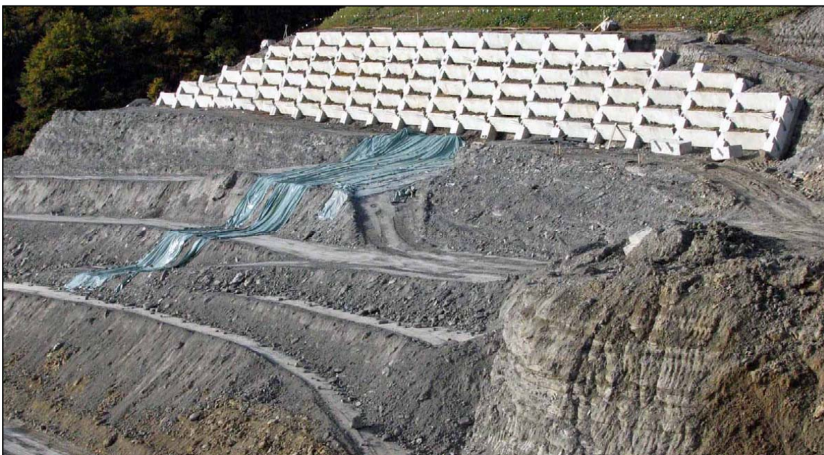
Slika 3.19: Razkrita nosilna tla v območju opornega zidu OZ-05 oktobra 2006.
