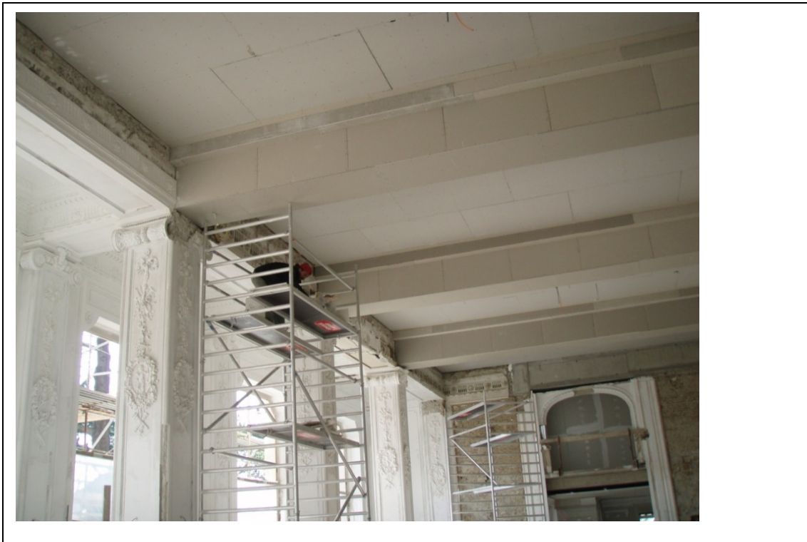
Slika 7: Izdelava nosilne podkonstrukcije za pritrditev rekonstruiranih štukaturnih elementov. (Istrabenz hoteli Portorož d.o.o., 2007)
