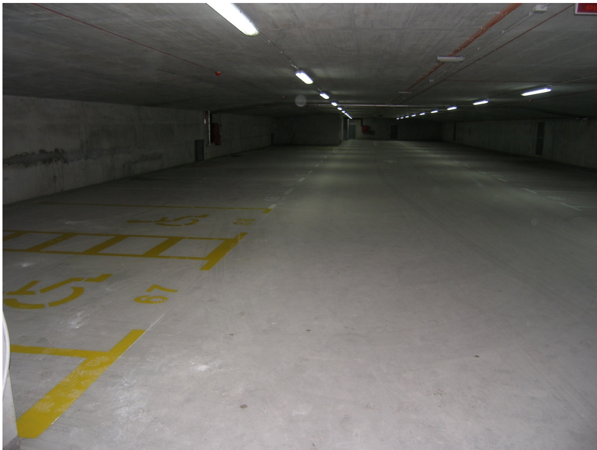
Slika 5: Prikaz neobičajnega razpona (širina 16,5 m) armiranobetonske plošče v garažni hiši brez vmesnih podpornih konstrukcij (Istrabenz hoteli Portorož d.o.o., 2006)
