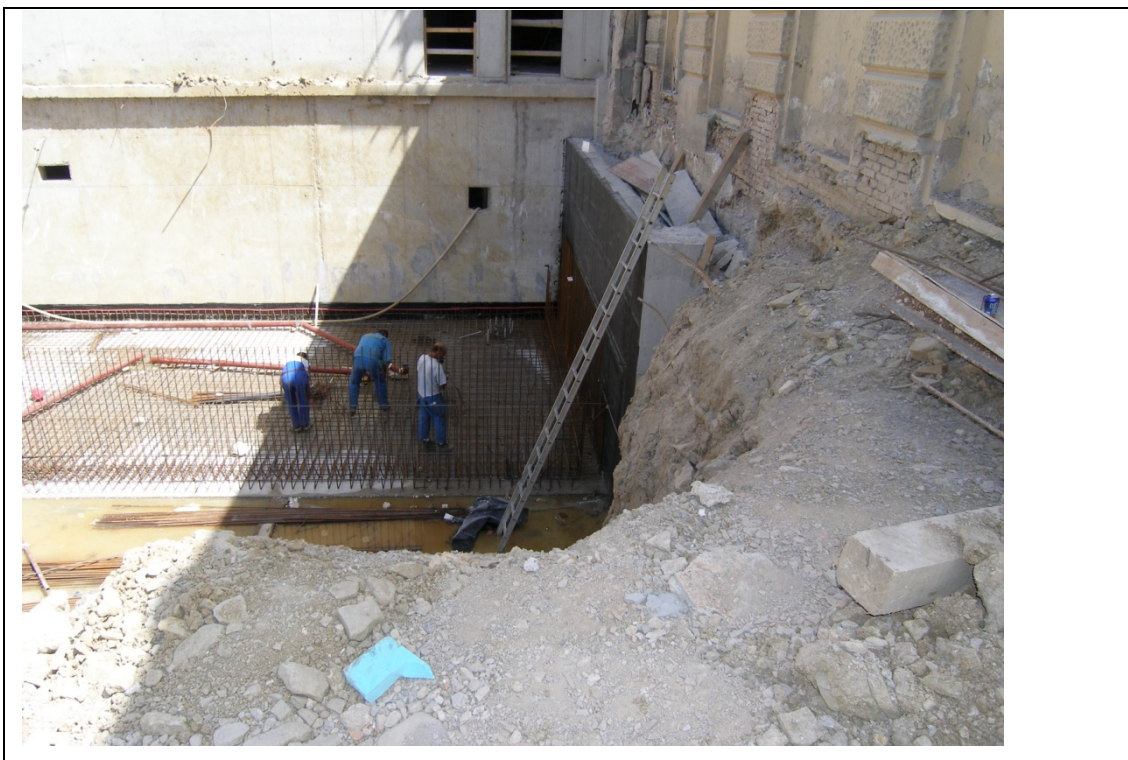
Slika 9: Izdelava temeljne plošče s predhodno izdelano podporno steno temelja sosednjega objekta (Istrabenz hoteli Portorož d.o.o., 2007)
