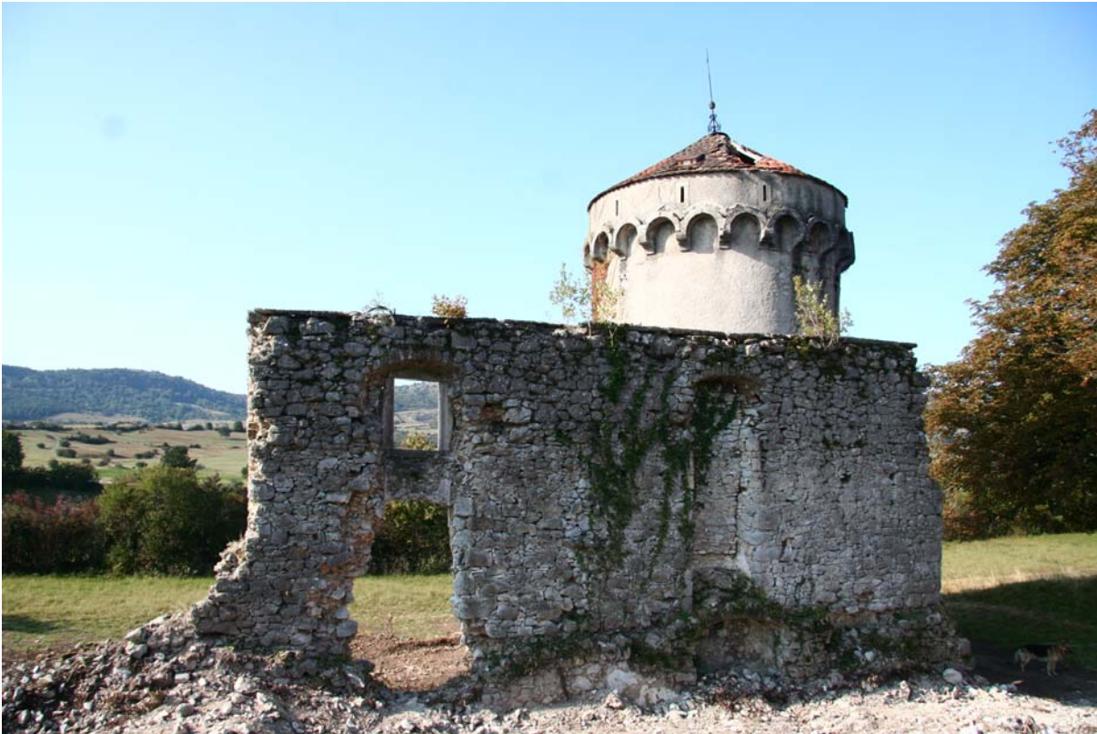
Slika 3: Grad Kalc pred obnovo leta 2010 z vidno propadajočo streho
