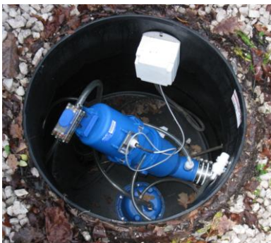
Slika 16: : 3" batni ventil Airvac v hišnem priključnem jašku
