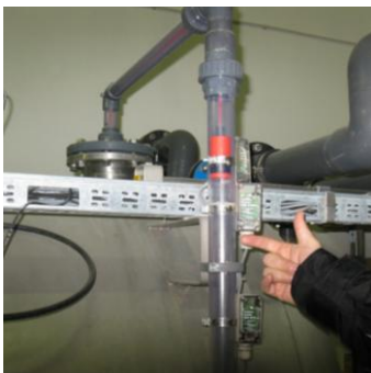
Slika 22: Plovec, ki kaže nivo vode v vakuumskem kotlu
