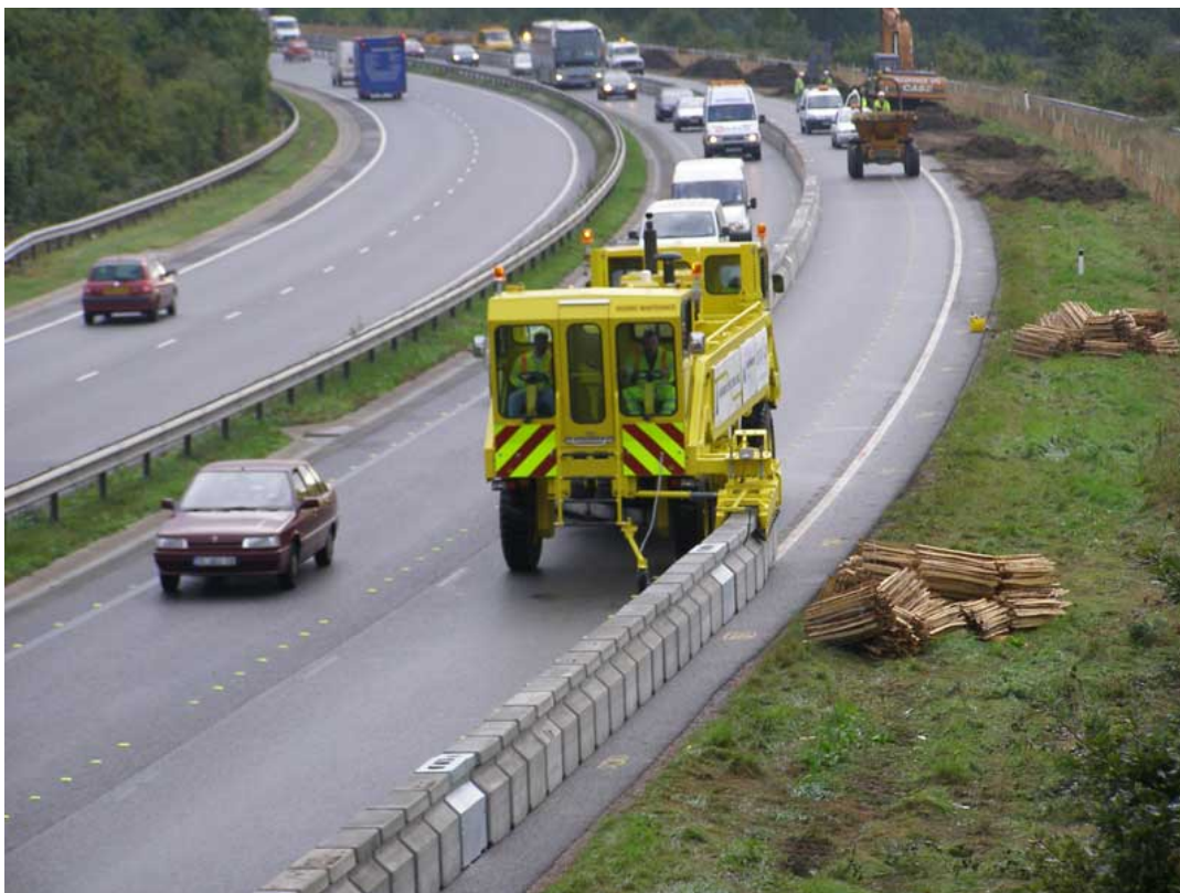
Slika 24: Neovirana površina vzdolž celotne dolžine rekonstruiranega dela ceste ali novogradnje [10]
