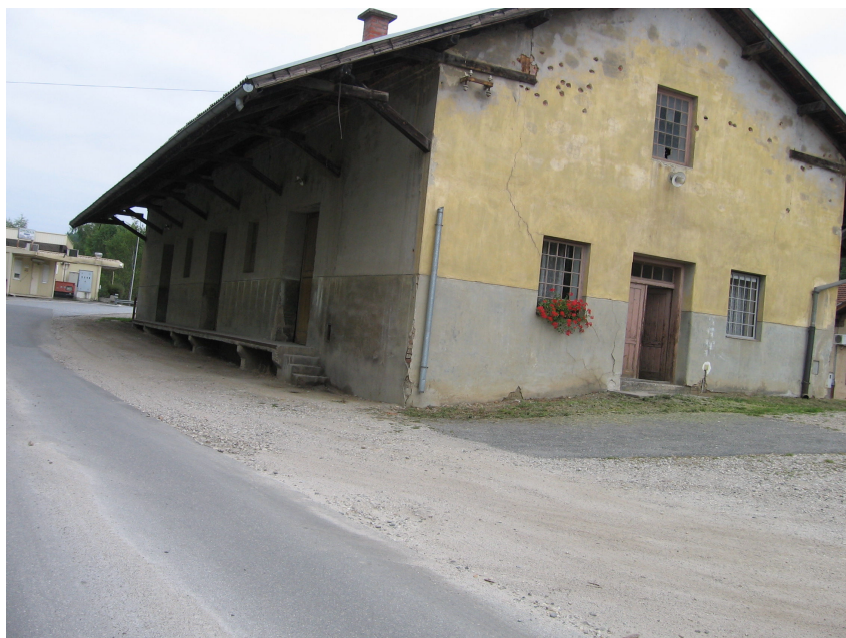
SLIKA 19: Tovorno skladišče Ormož v zelo slabem stanju
