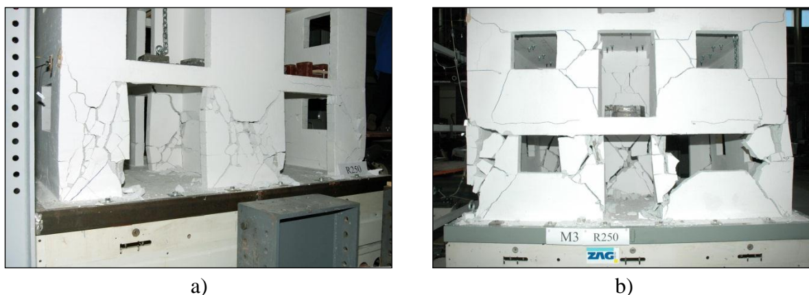
Slika 21: Tipične poškodbe zidov modelov pri mejnem stanju porušitve. a) model M2; b) model M3. Parapeti niso poškodovani
