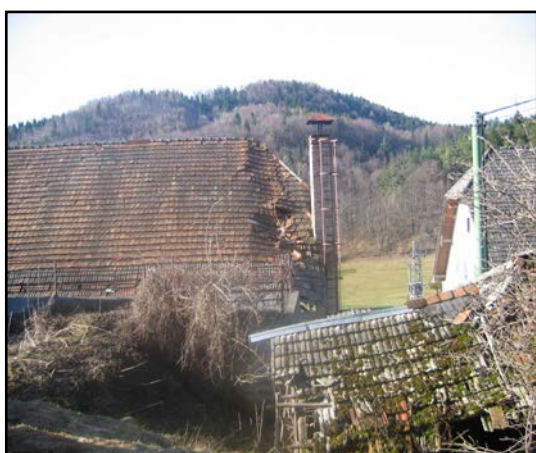
Slika 73: Razpadajoči obrtni objekti
