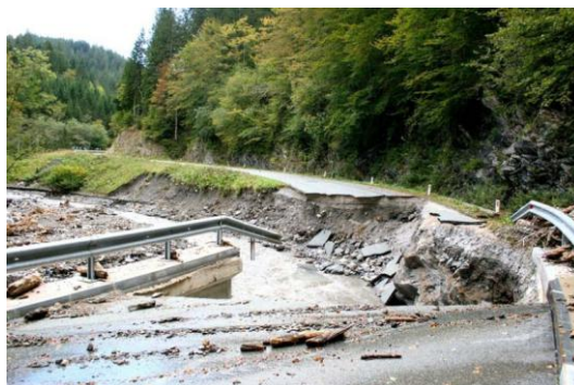
Slika 16: Močna bočna erozija Zadnje Sore je močno preoblikovala strugo in odnesla nekaj metrov ceste (ARSO, 2007b).
