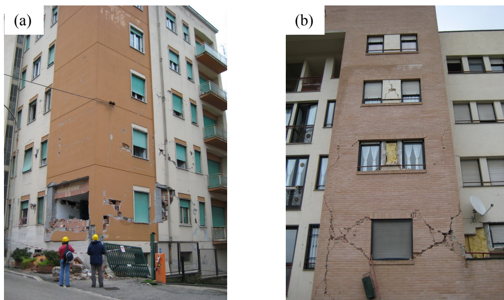
Slika 12: Poškodbe zaradi potresa L'Aquila (a) na objektu v kraju L'Aquila in (b) na objektu v kraju Pattino
