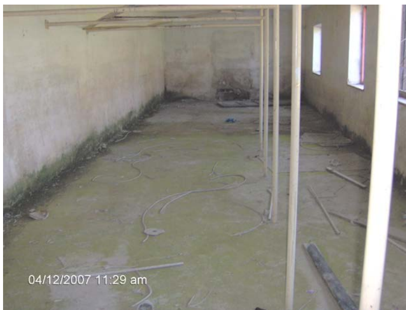
Slika 8: Območje nekdanje kegljaške steze. Razvidne so sledi vlage na betonskih elementih, problem je še posebej značilen za stike med zidom in AB ploščo. (foto: Jeriha, 2007)
