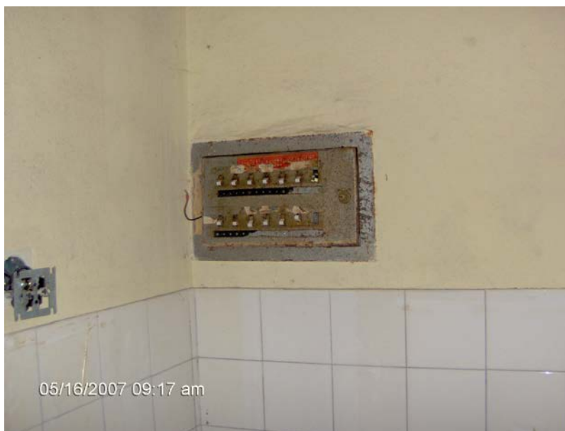
Slika 21: Originalna električna omarica z varovalkami v spodnji etaži, pozicionirana cca 1m pod gladino 100 letne vode.(foto: Jeriha, 2007)
