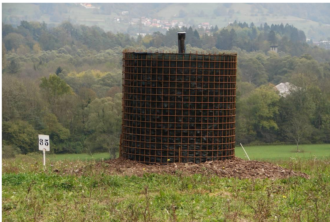
Slika 9: Začasni izpust obstoječega plinjaka.
