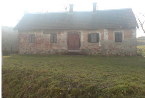
Slika 29: Objekt potreben prenove (Vir: A. Rob, 2008)
