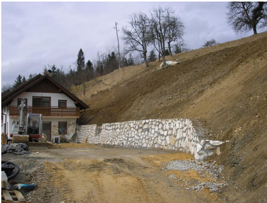
Slika 29: Sanirani plaz Zupanc Majde, Račica 39, Loka (občina Sevnica – g. Joško Žvar)
