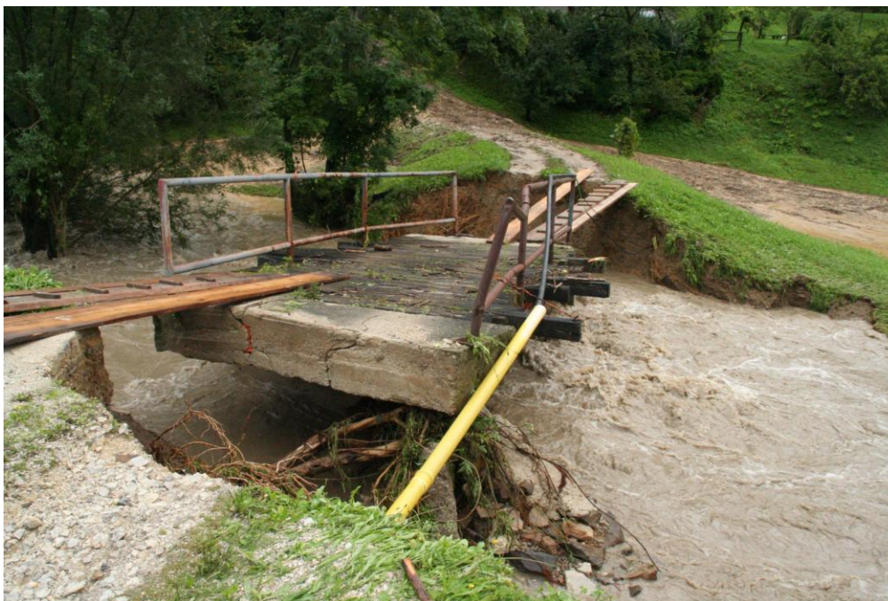
Slika 35: Porušeni most do stanovanjskih hiš Popelar, Horjak (občina Sevnica – g. Joško Žvar)
