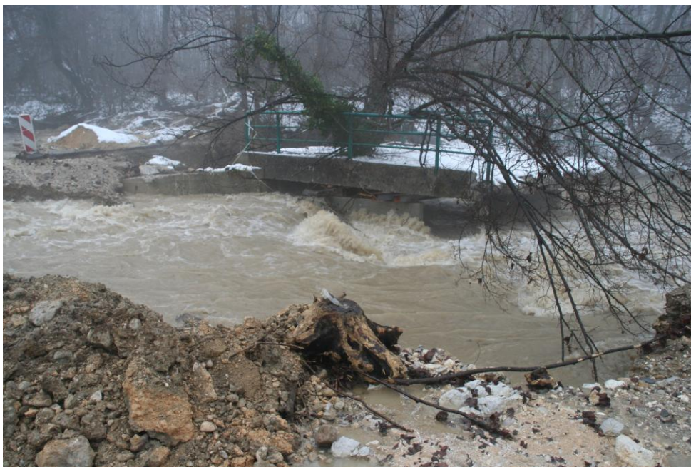
Slika 33: Porušen most na LC Blanca – Poklek (občina Sevnica – g. Joško Žvar)
