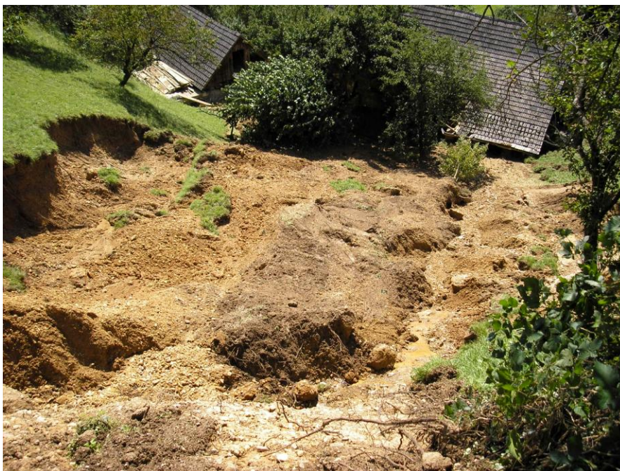
Slika 30: Zemeljski plaz nad gospodarskim objektom Radič Avgust, Florjanska (občina Sevnica – g. Joško Žvar)
