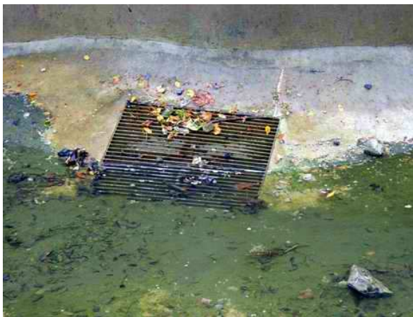
Slika 66: Talni izpust bazena
