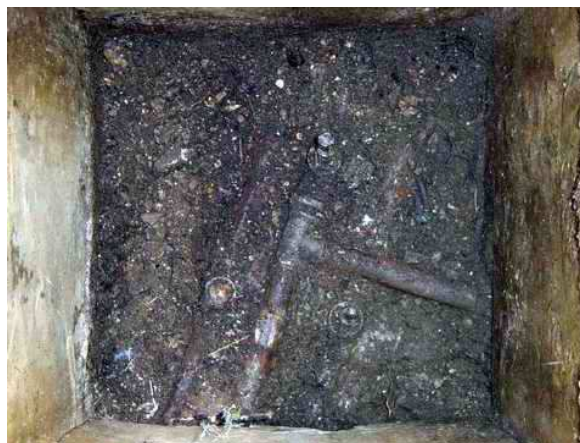
Slika 52: Jašek poleg cisterne C6 v parku – vidne so tri dotočne cevi z zapornimi ventili
