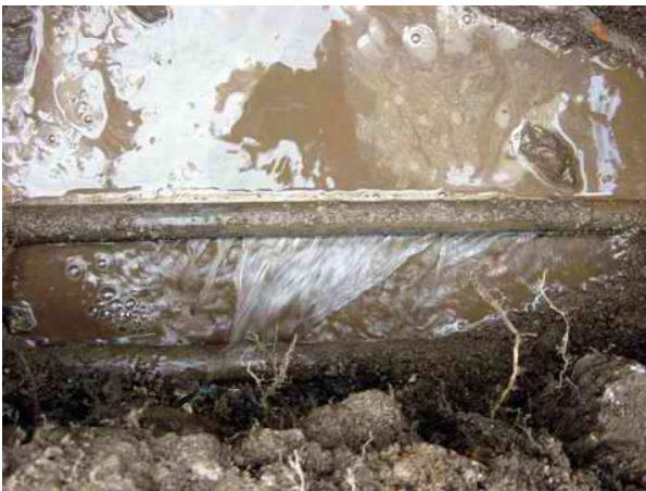
Slika 58: Poškodba – puščanje cevi
