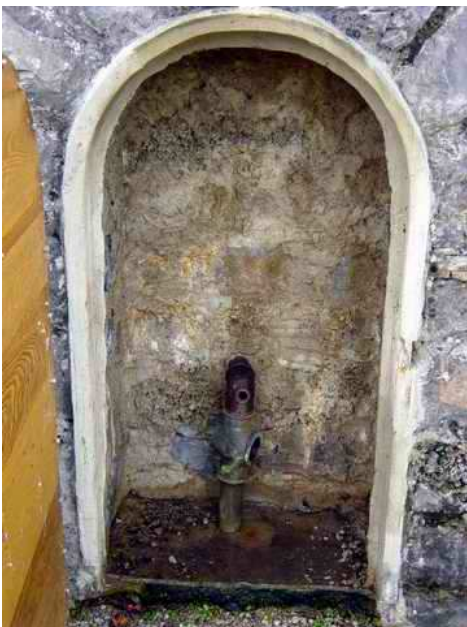
Slika 53 Niša z glavnim ventilom
