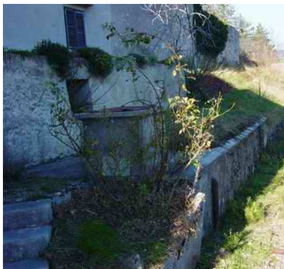
Slika 44: Cisterna C2 nad promenado s pergolo
