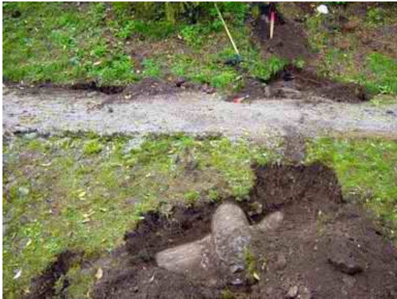
Slika 55: Stik dveh betonskih cevi
