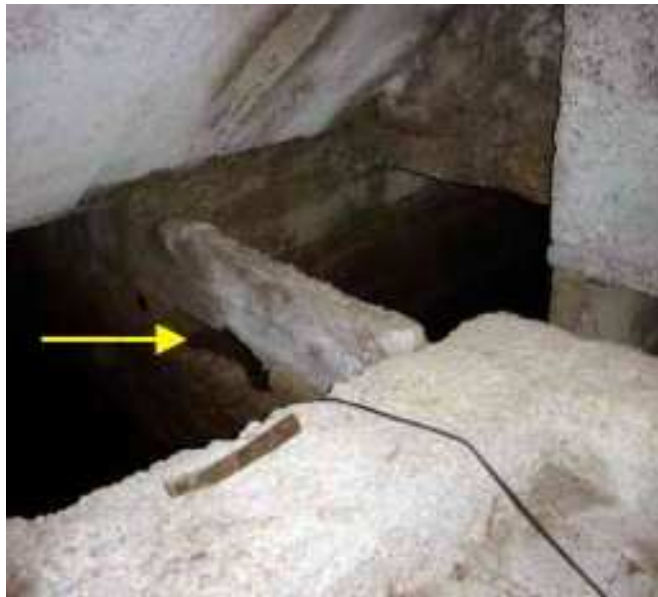
Slika 42: Notranjost cisterne C1, vidna poškodba na prekatni steni
