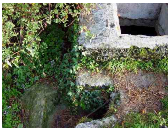
Slika 43: Naknadno narejen neposreden dotok vode v cisterno
