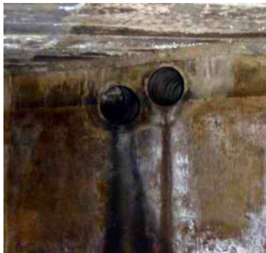
Slika 50: Dotočna (levo) in odtočna (desno) betonska cev \phi 200 mm
