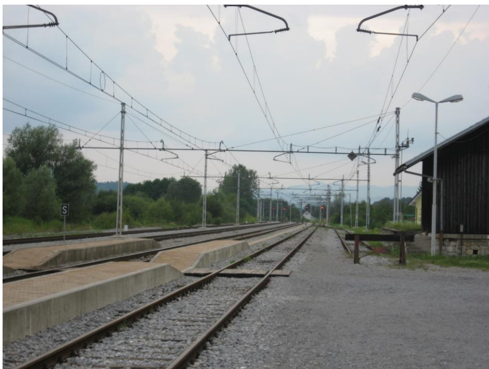
Slika 16: Železniška postaja Brezovica (pogled v smer Vrhnike) - mesto odcepa nove proge Ljubljana Vrhnika od obstoječe proge Ljubljana – Sežana
