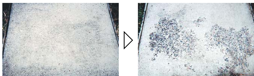
Slika 5.3: Primer luščenja betona zaradi zmrzovanja in tavanja v prisotnosti talilnih soli (PCA, 2003)
