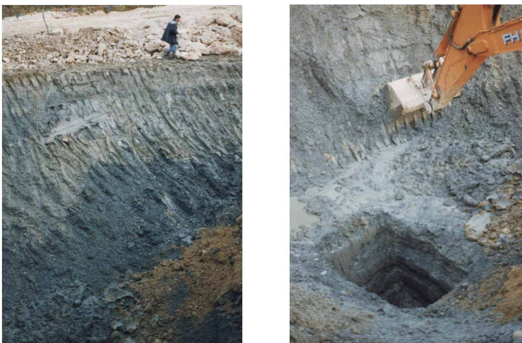
Slika 5.11 Poizkus izkopa temeljne pete pod nasipom na območju profilov P100 do P114: na levi sliki je prikazan izkop pete do prvega izkopnega nivoja, na desni sliki pa je prikazan izvedeni sondažni izkop do predvidenega dna pete nasipa. V sondažnem izkopu je vidno menjavanje slabo prepustnih pretežno glinenih in dobro prepustnih peščeno meljnih plasti v temeljnih tleh.
