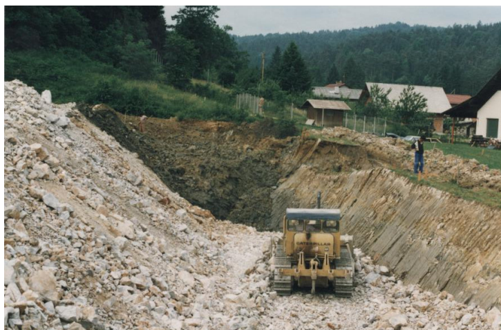
Slika 5.14 Vgrajevanje gruščnatega materiala v temeljno peto pod nasipom na območju profilov P70 do P80
