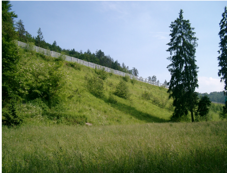
Slika 5.43 Končni izgled vzhodne brežine nasipa na območju profilov P100 do P114 (pogled iz naselja Bizovik)
