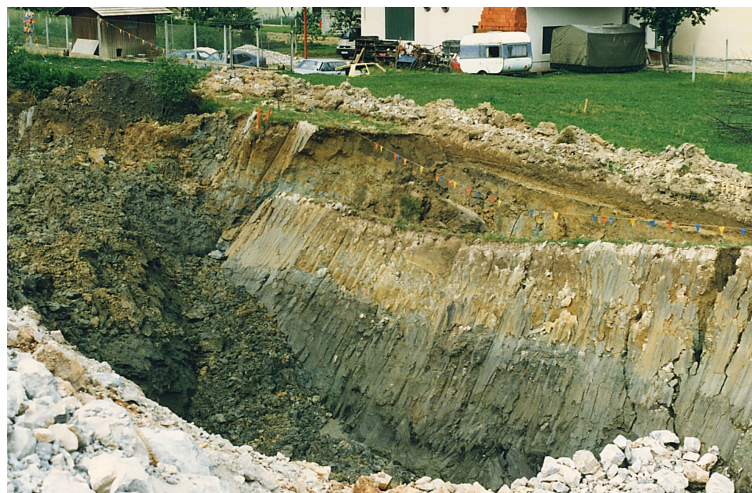
Slika 5.10 Usad v začasni strmi brežini, ki je nastal med izvajanjem izkopa za temeljno peto nasipa na območju profilov P70 do P80.
