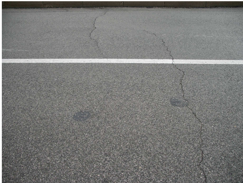
Slika 21: Stanje vozne površine na mestu odvzema asfaltnih jeder: testni odsek 5
