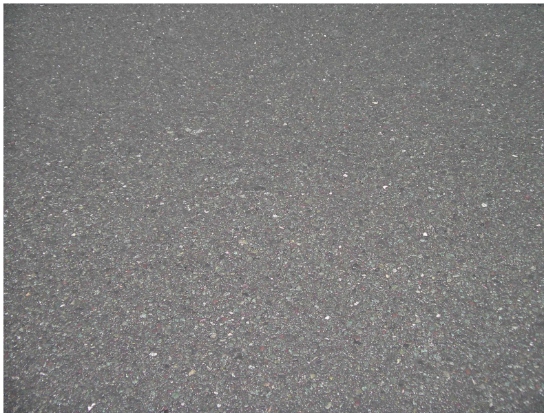
Slika 15: Stanje vozne površine na mestu odvzema asfaltnih jeder: testni odsek 2
