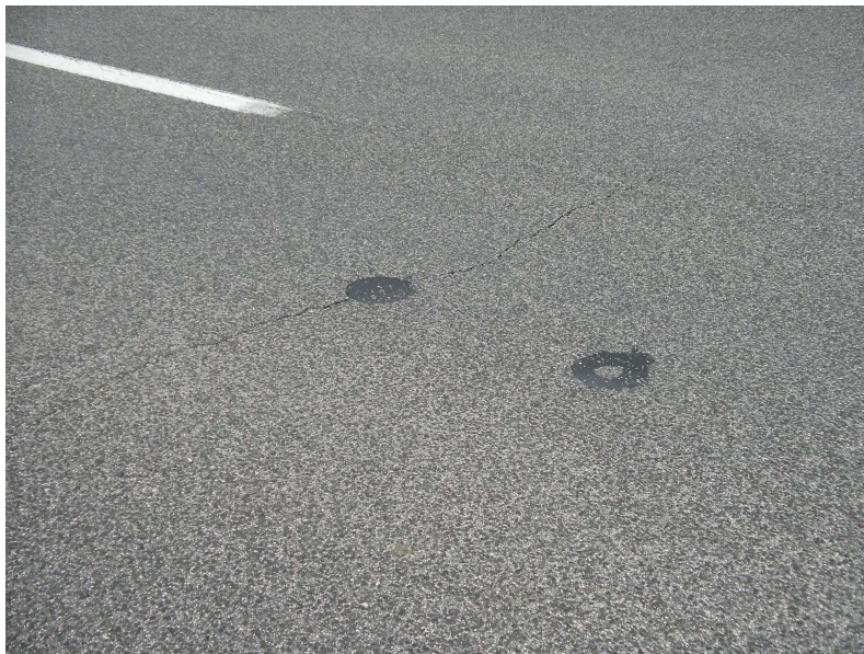
Slika 19: Stanje vozne površine na mestu odvzema asfaltnih jeder: testni odsek 4
