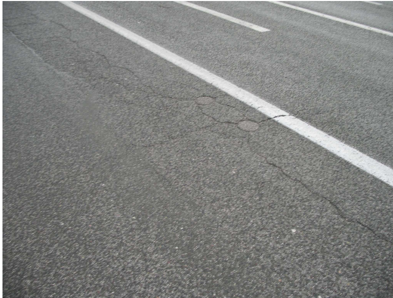
Slika 13: Stanje vozne površine na mestu odvzema asfaltnih jeder: testni odsek 1
