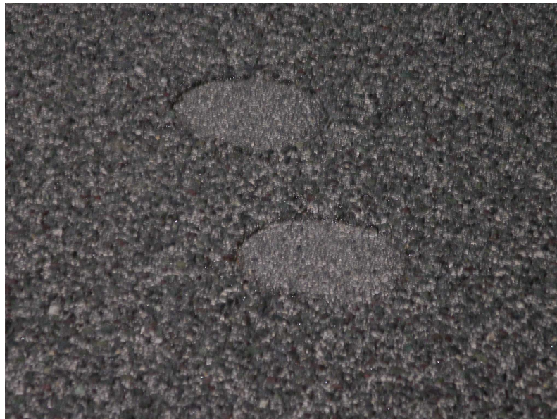
Slika 23: Stanje vozne površine na mestu odvzema asfaltnih izvrtin: testni odsek 6
