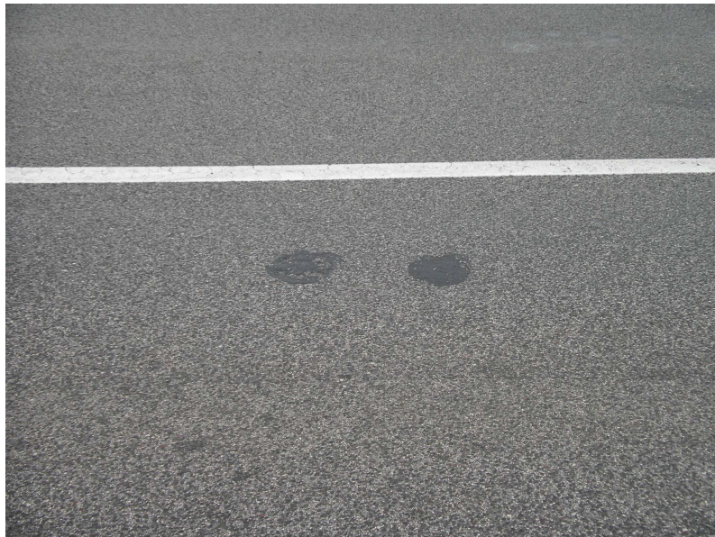
Slika 17: Stanje vozne površine na mestu odvzema asfaltnih jeder: testni odsek 3
