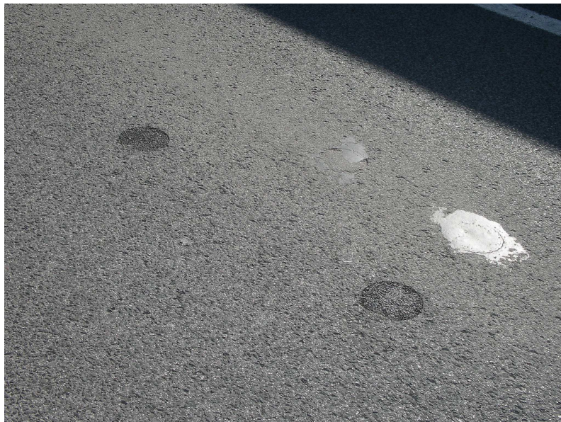
Slika 31: Stanje vozne površine na mestu odvzema asfaltnih jeder: testni odsek 10
