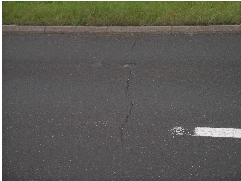
Slika 27: Stanje vozne površine na mestu odvzema asfaltnih jeder: testni odsek 8
