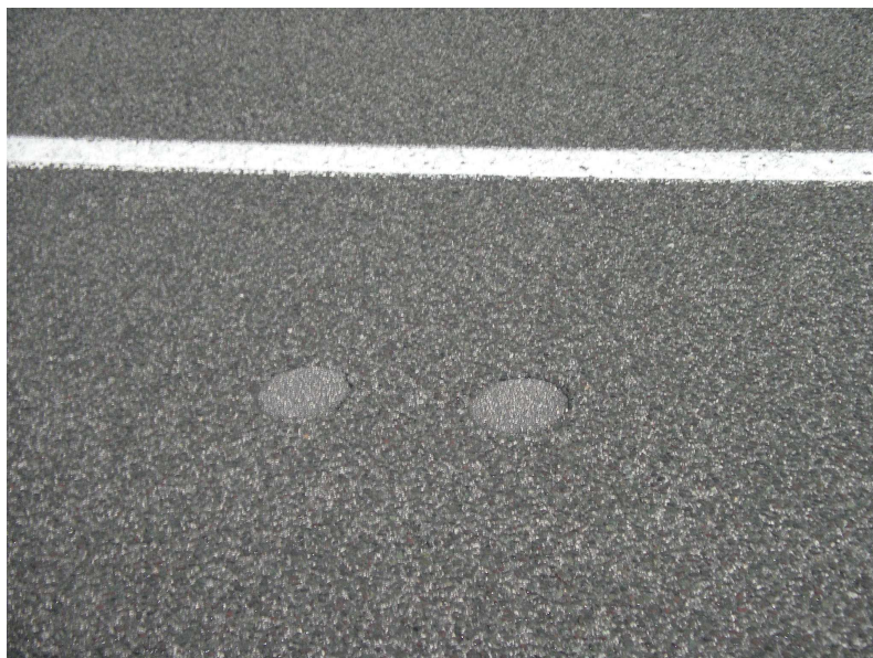
Slika 25: Stanje vozne površine na mestu odvzema asfaltnih jeder: testni odsek 7
