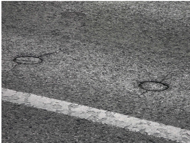
Slika 29: Stanje vozne površine na mestu odvzema asfaltnih jeder: testni odsek 9
