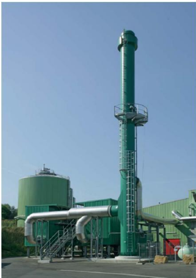
Slika: Dimnik in priključena RTO napravi (Merten in sod, 2006)
