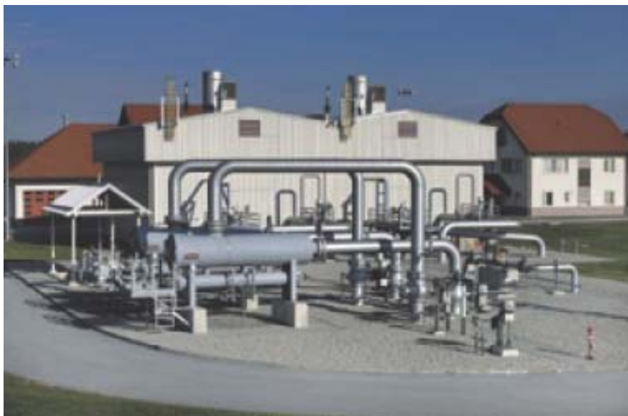
Slika 6: Kompresorska postaja Kidričevo (Vir: Geoplin plinovodi, 2007)
