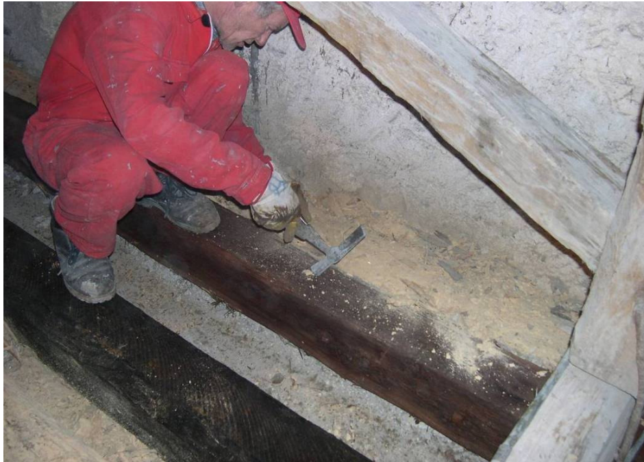
Slika 7.2: Poškodbe lesenega stropnika, ki je bil po celi dolžini v stiku z injektiranim zidom in brez ustreznega zračenja
