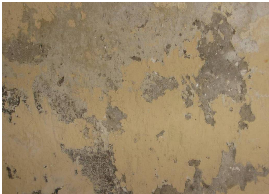
Slika 7.1: Poškodbe vrhnjih slojev ometa injektiranega zidu, do katerih je prišlo zaradi prekratkega časa sušenja zidu v zimskem obdobju
