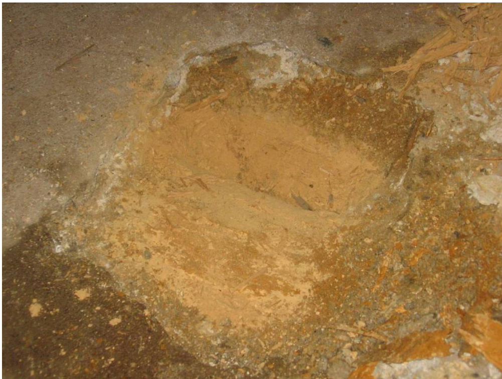
Slika 7.4: Globinska sonda je razkrila popolnoma prhle lesene stropnike, preko katerih je bil izveden cementni estrih brez ustrezne zaščite
