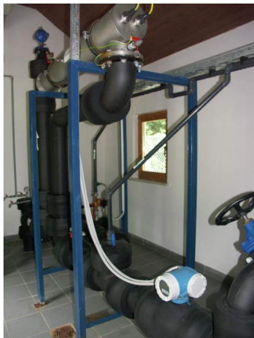
Slika 9: Črpališče Vodice – notranjost
