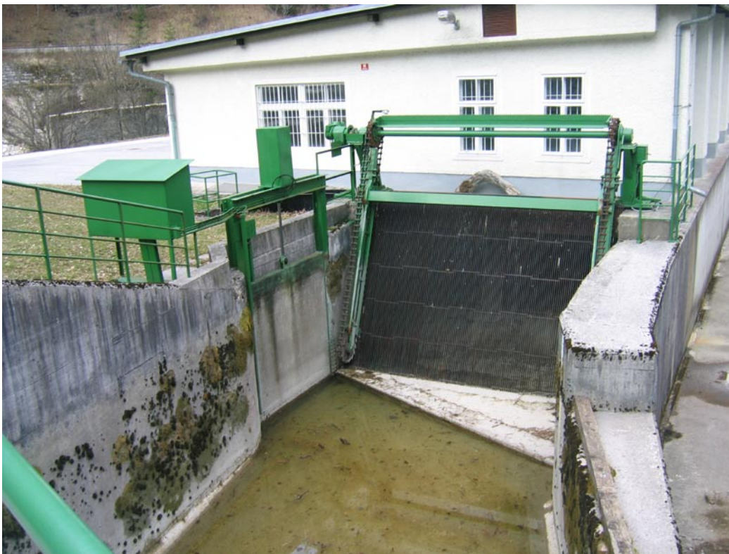
Slika 3.3: Fine rešetke s čistilnim strojem (HE Soteska)
