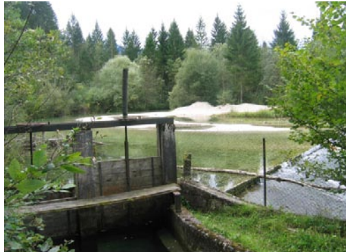
Slika 5.3: Tablaste zapornice na vstopu v dovodni kanal in jez na Bistrici
