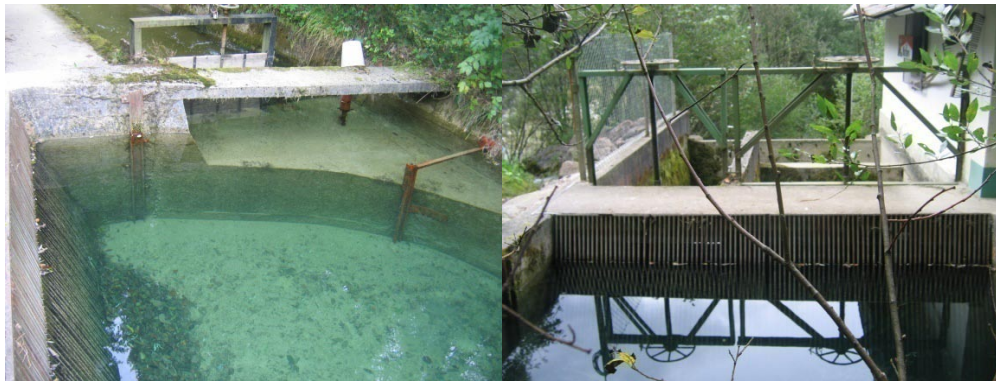
Slika 5.4: Drobna rešetka pred predturbinskimi zapornicami, ter pričetek dovodnega kanala za ribogojnico z tablasto zapornico in prelivom.
