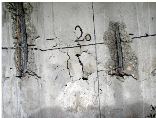
Delaminacija betona zaradi uklona armaturnih palic na notranji površini stebra 2 pri pomiku \delta = 100,0 mm (Bevc, 2006)
