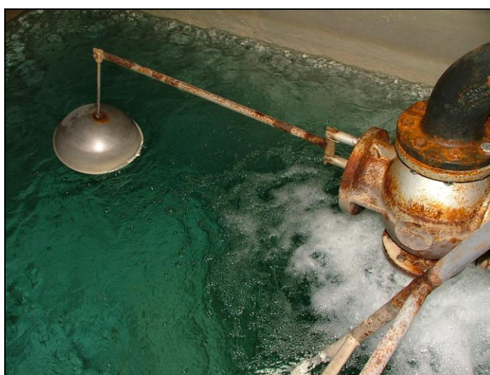
Slika 3: Plovni ventil v raztežilniku Piran
