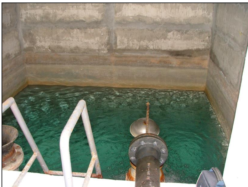
Slika 2: Pogled na vodovodno celico
