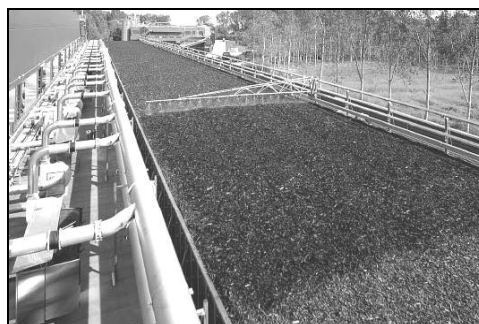
Slika 8.2: Biofiltri na strehi objekta (Ignjatovič, 2007, str. 9)
