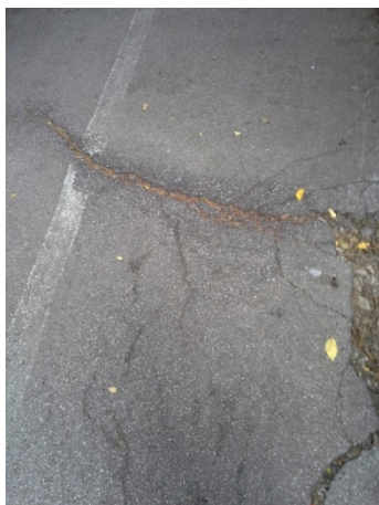
Slika 22: Poškodovana kolesarska pot: lokacija: Večna pot
