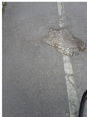
Slika 23: Poškodovana kolesarska pot, lokacija: Večna pot
