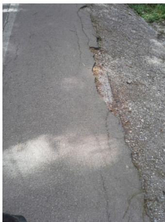
Slika 24: Poškodovana kolesarska pot, lokacija: Večna pot
