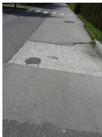
Slika 26: Poškodba na mešanem profilu, lokacija: Ulica bratov Bezlajev
