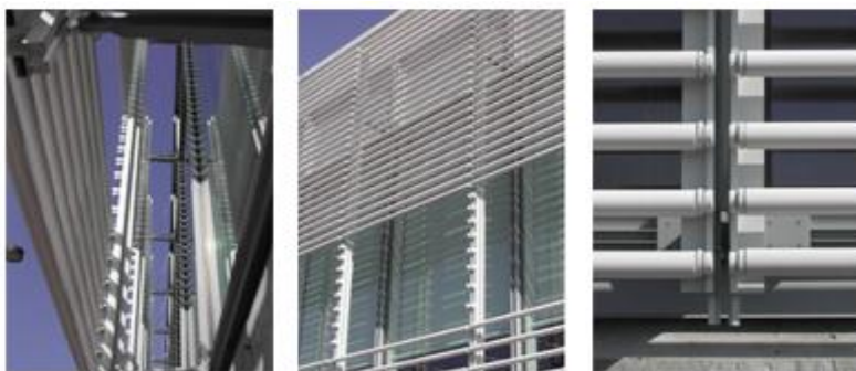
Slika 12: Senčila iz horizontalnih keramičnih cevi na stavbi NY Time's [35].
