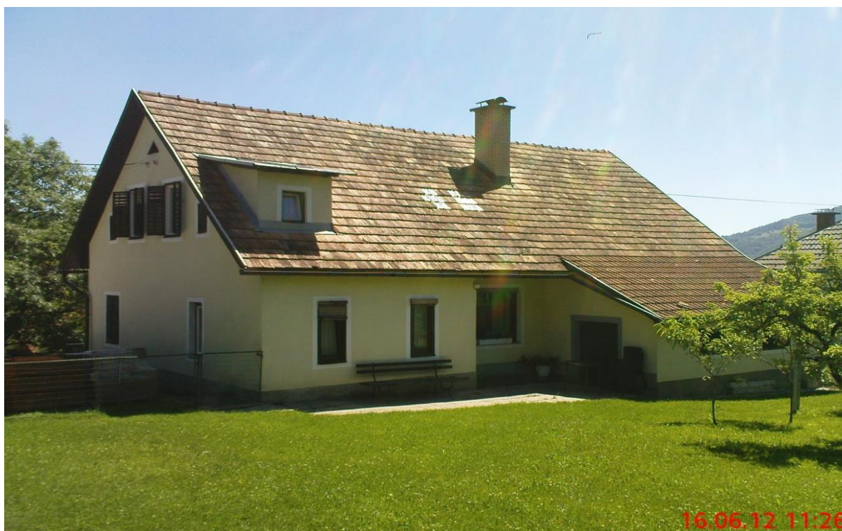
Slika 12: Stanje pred prenovo strehe leta 2012
