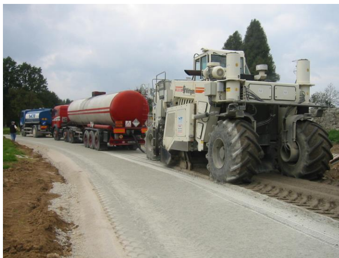
Slika 2 Recikator in cisterni (vir: Hevka, 2010.)
