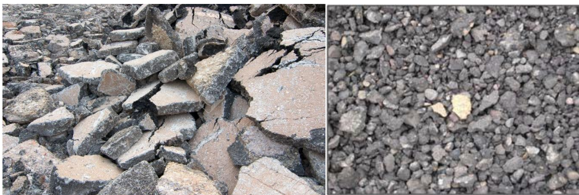
Slika 5 Porušen asfalt v obliki plošč (levo) in ne sejani asfaltni drobljenec (vir: Copeland, 2011)
