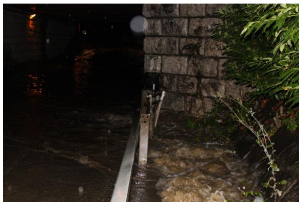
Slika 17: Prepust pod cesto med poplavo 15.6.2016 okoli 3:00 (foto: Ivo Pertot)
