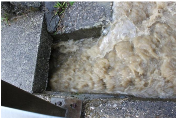
Slika 14: Kanal pod dovozom na dvorišče ob visoki vodi 11.6.2016 (foto: Ivo Pertot)
