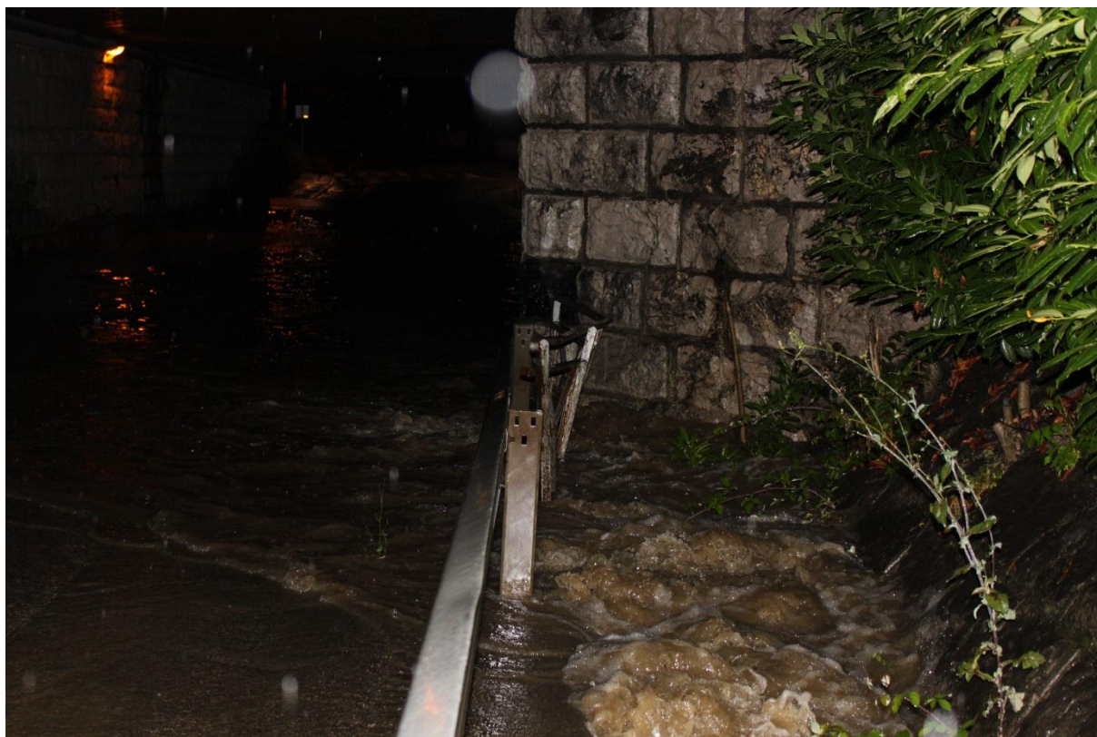
Slika 6: Poplavljen prepust pod cesto ob zadnji poplavi 15.6.2016 okoli 3:00 (foto: Ivo Pertot)
