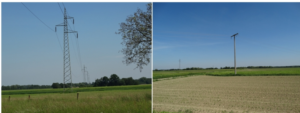
Slika 31: Prikaz daljnovodnih stebrov na območju Občine Tišina (Fotografija: M. Rudolf, 2016)
